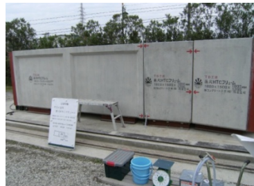
変位実験状況
