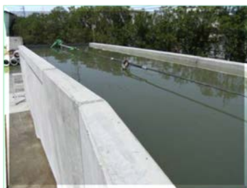
変位後の漏水なし
