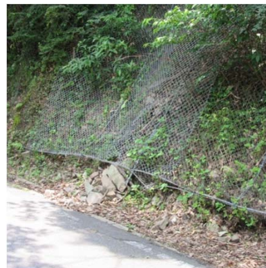
落石防護網裾のこぼれ出し状況
