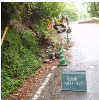
小規模崩壊の状況
