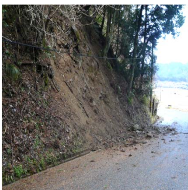
施工前：斜面崩壊
